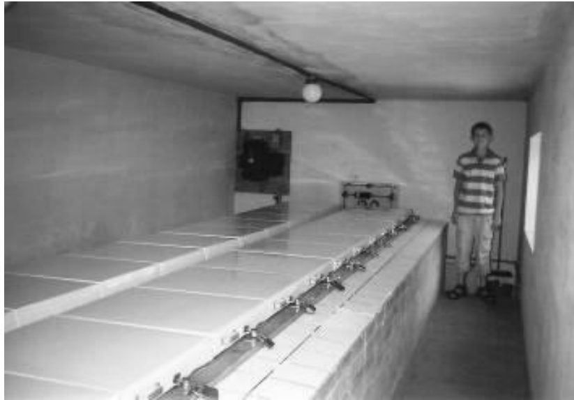
Fryseriets boksrums. Kølemaskinen skimtes længst tilbage. Foto 2008.
